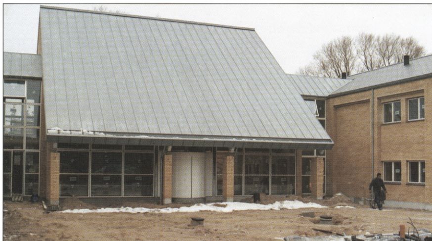
Det store zinktag giver midterflojen et markant udseende. Der er reception og lagerlokale i stueetagen og på 1. sal er der mødelokaler og kantine.
